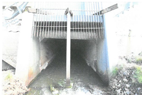
Widok od strony wlotu przepustu: widoczna górna płyta ramy pierwszej sekcji przepustu – przemieszczenia i obrót świadczą o utracie stateczności pierwszej sekcji przepustu 2019-08-03
