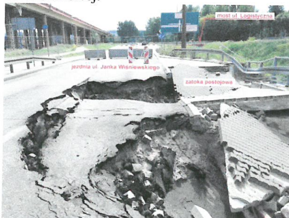
Widok na konstrukcję nawierzchni w obrębie jezdni i zatoki postojowej stan po awarii 2019-08-12
