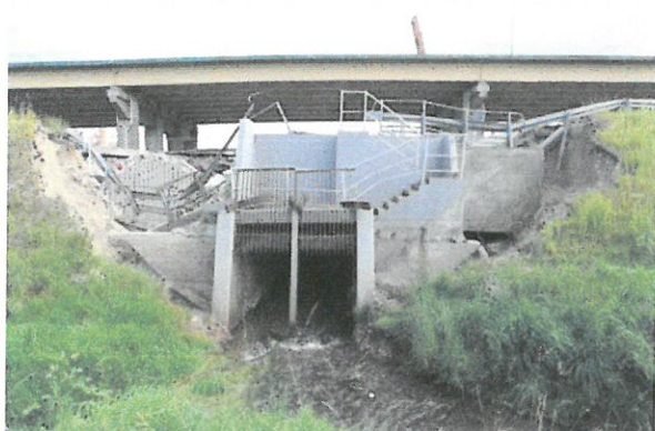
Widok od strony wlotu przepustu: utrata stateczności: obrót i przemieszczenie pierwszej sekcji ramowego przepustu oraz konstrukcji pomostu obsługowego wraz ze schodami i ścianami oporowymi 2019-08-03
