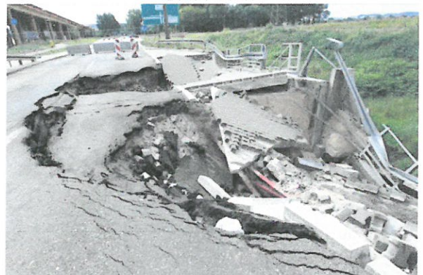
Widok od strony ul. Kontenerowej osunięcie gruntu i umocnienia skarpy nasypu wokół konstrukcji wlotu oraz obsunięcie warstw nawierzchni drogi – ulicy Janka Wiśniewskiego wraz z zatoką postojową i infrastrukturą drogową 2019-08-03
