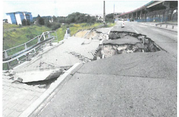
Obsunięcie warstw nawierzchni drogi – ulicy Janka Wiśniewskiego wraz z zatoką postojową i infrastrukturą drogową 2019-08-03
