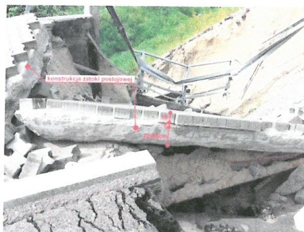
Szczegół nawierzchni w obrębie zatoki postojowej stan po awarii 2019-08-12
