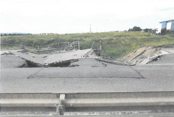
Widok od strony Portu – wyraźnie widoczne obsunięcie i podmycie gruntu wraz z nawierzchnią i infrastrukturą drogową wokół konstrukcji przepustu 2019-08-03
