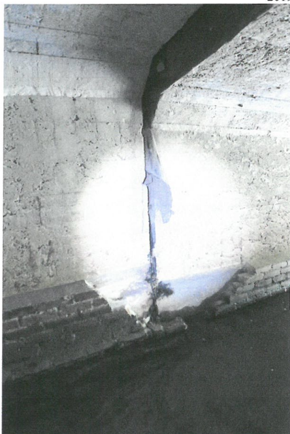
Szczegół dylatacji między pierwszym i drugim segmentem ramowej konstrukcji przepustu w obrębie ściany pionowej i płyty stropowej od strony ul. Logistycznej, widoczne przemieszczenia sekcji pierwszej w stosunku do sekcji drugiej przepustu 2019-08-03
