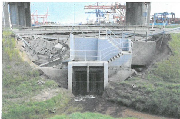
Widok po awarii wlotu oraz pomostu obsługowego ze schodami i ścianami oporowymi 2019-06-22
