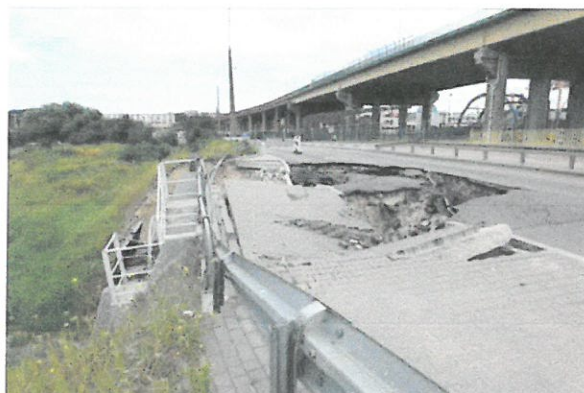
Widok z góry po awarii pomostu obsługowego i pasażatki postojowej 2019-08-03
