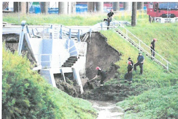
Akcja interwencyjna Straży Pożarnej – znaczne ograniczenie powierzchni czynnej przepływu na kratkach na wlocie do przepustu
