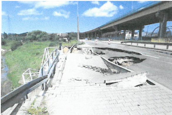
Obsunięcie warstw nawierzchni drogi – ulicy Janka Wiśniewskiego wraz z zatoką postojową i infrastrukturą drogową 2019-06-22
