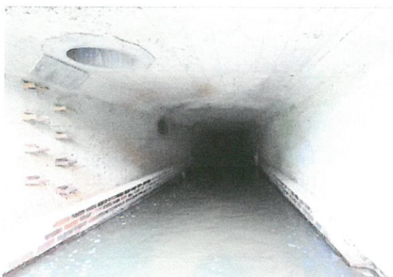
Widok wnętrza pierwszej sekcji (od strony wlotu) przepustu ramowego pod ulicą Janka Wiśniewskiego 2019-08-03
